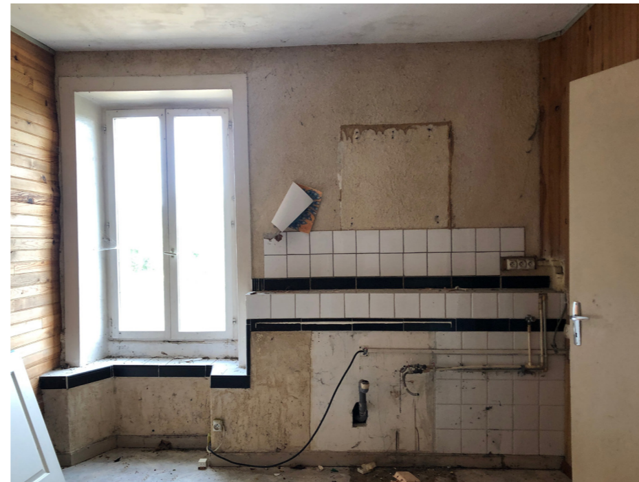
Par ailleurs, la vacance du lieu depuis de nombreuses années à amené des désordres. On note des vieillissements de matériaux, des fuites, des infiltrations et un peu de vandalisme.
