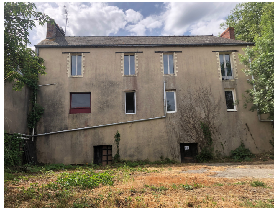
La façade Nord - très visible dans le paysage - est très brutaliste avec un enduit monochrome gris et de petites ouvertures verticales. La présence de divers réseaux cheminant en façade lui donne un aspect technique peu valorisant.
